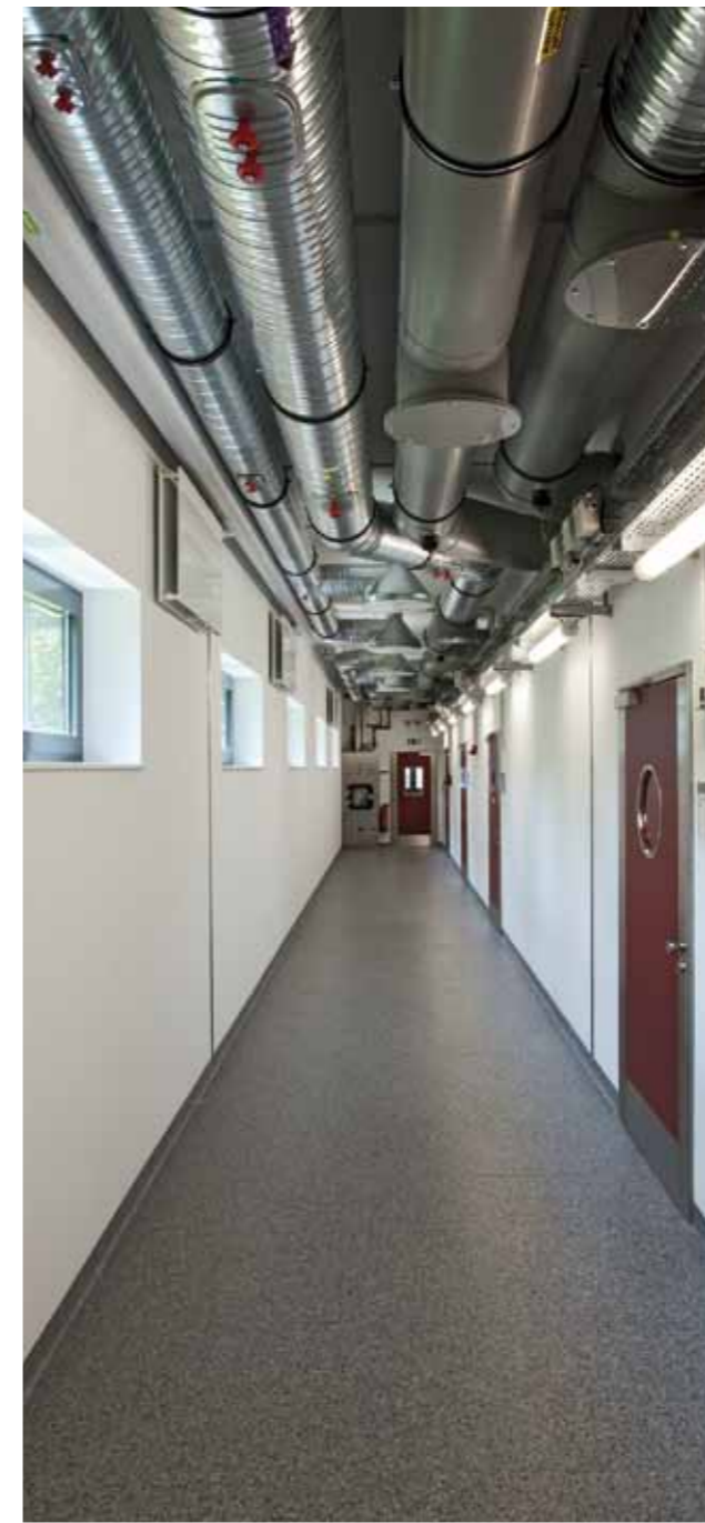
Technikflur Technical corridor
